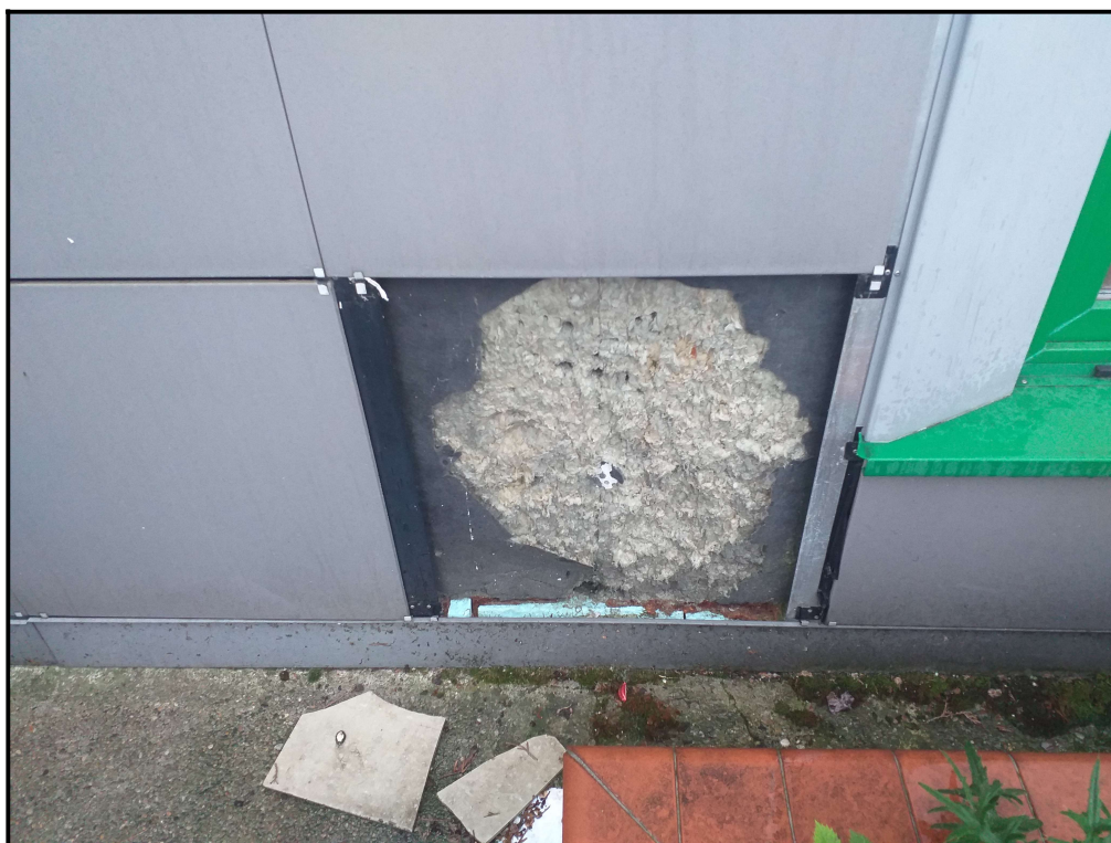
Fot. 7.10. Przykład odsłoniętej i zniszczonej izolacji termicznej
