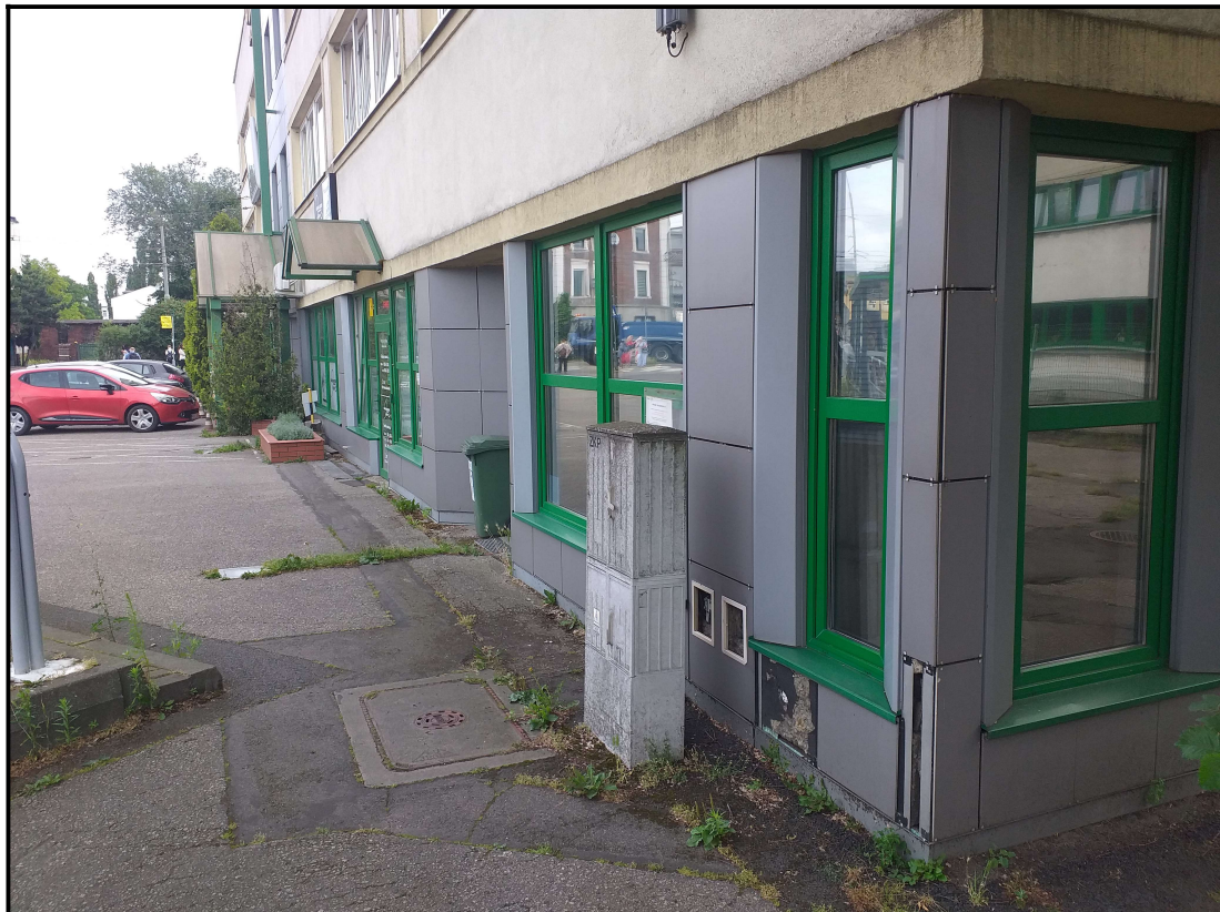
Fot. 7.7. Otwory okienne stanowiące znaczną część elewacji
